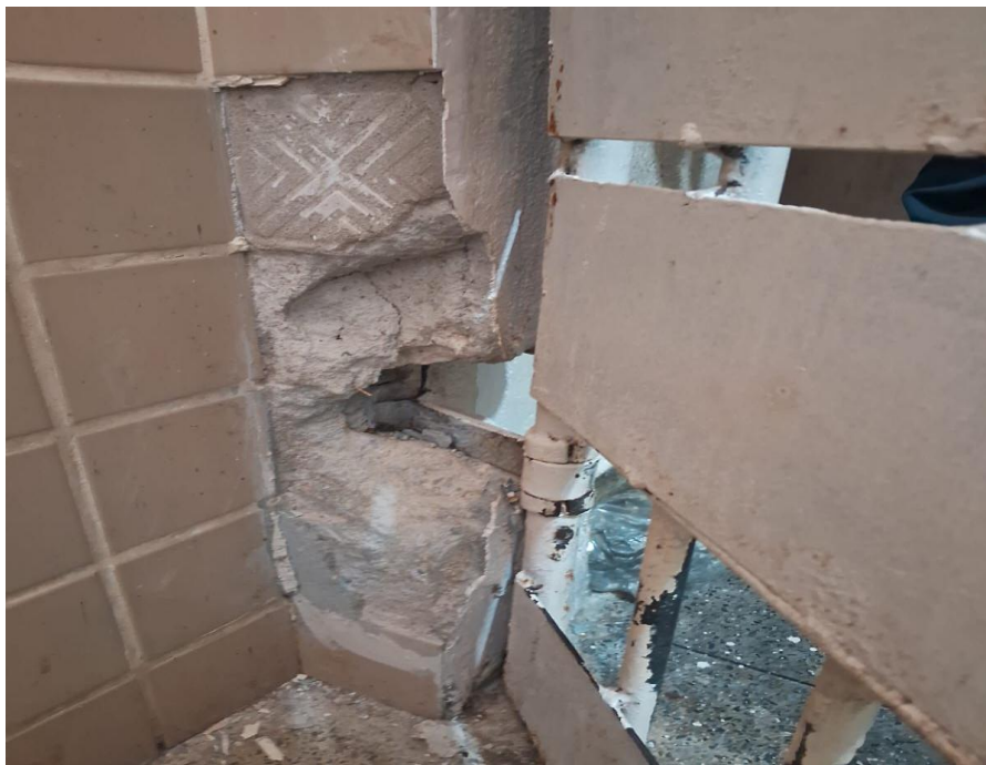
imagem 17: parte interna da cela masculina com concreto quebrado e parte metálica exposta
