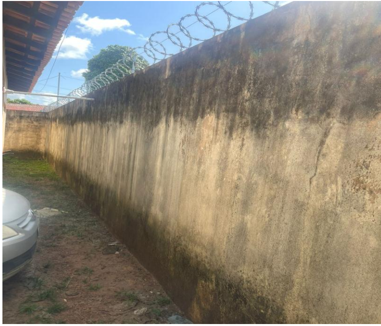
imagem 18: parede do muro com pintura comprometida e tomada pelo lodo
