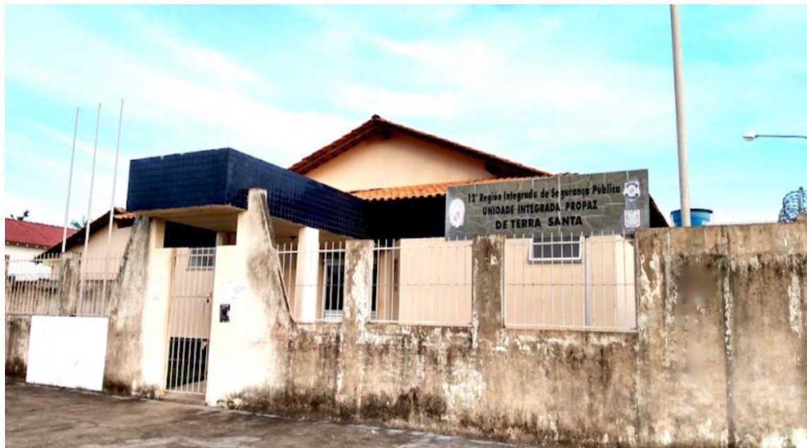
imagem 01: fachada da Delegacia de Polícia Civil com pintura comprometida e tomada pelo lodo
