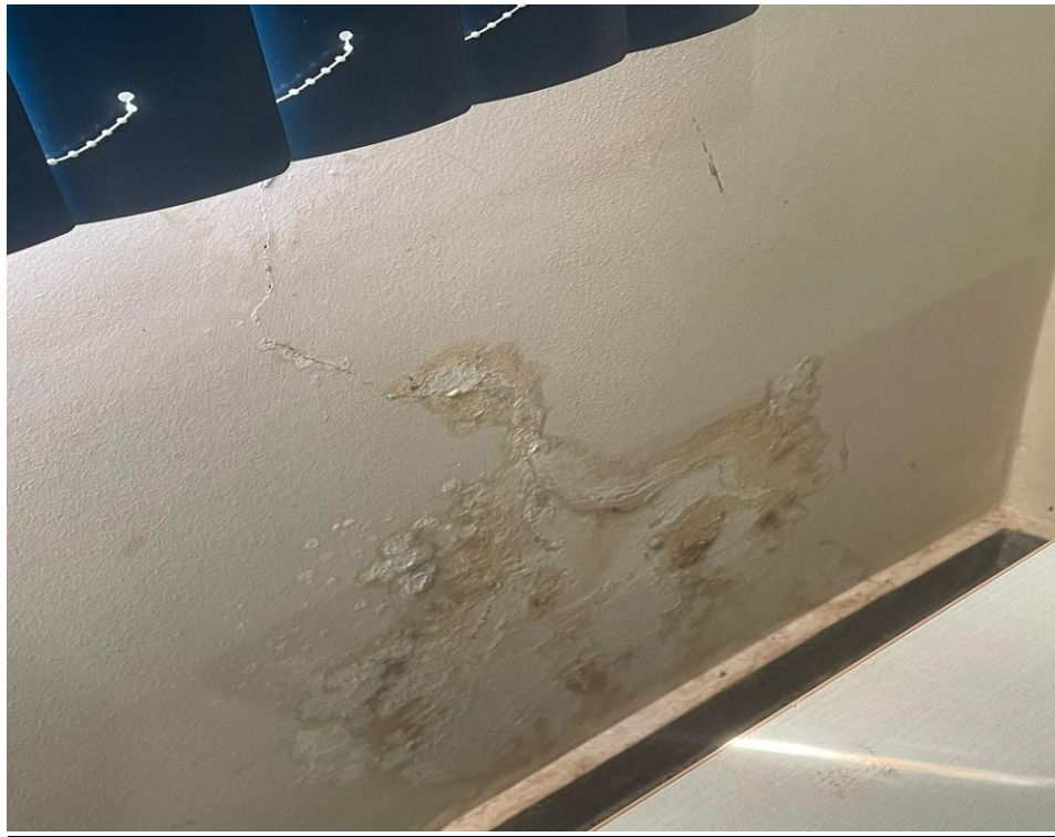
imagem 06: infiltração na parede do gabinete do Delegado de Polícia
