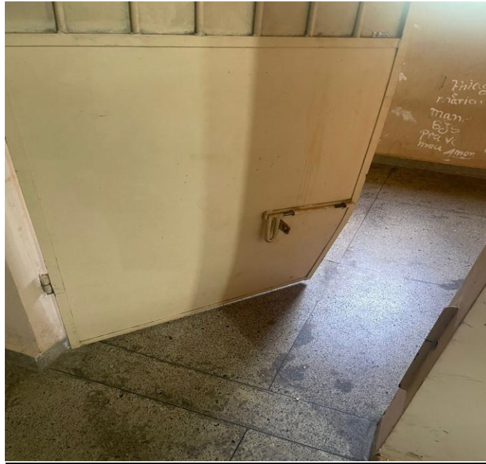
imagem 12: porta da cela feminina "torta"/danificada
