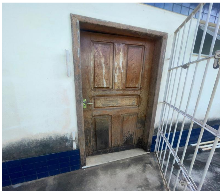
imagem 15: porta com a base "podre"/deteriorada
