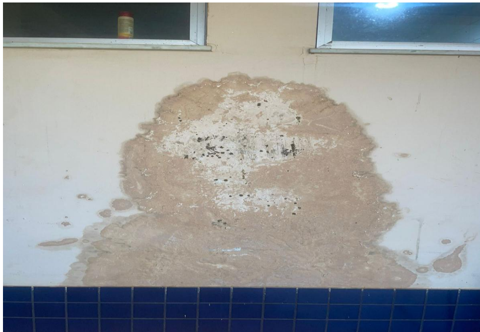
imagem 07: infiltração na parede da copa da Delegacia de Polícia
