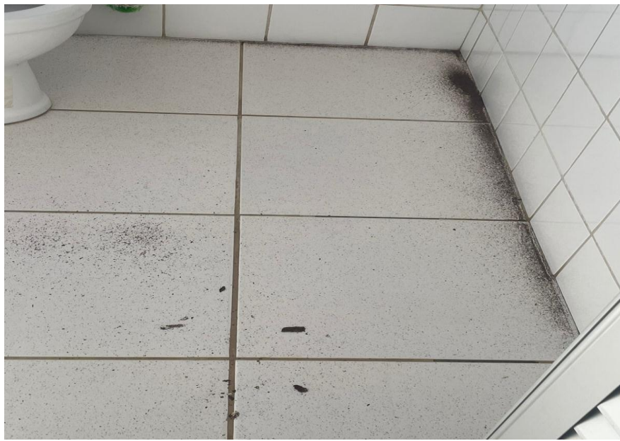
imagem 03: dejetos de morcegos e cupins no piso do banheiro
