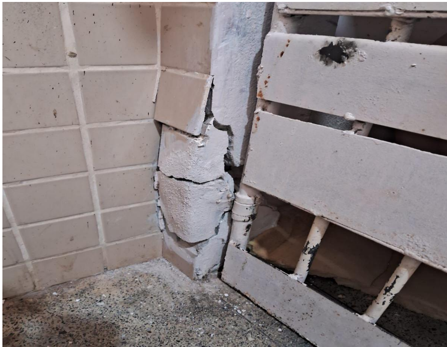
imagem 16: parte externa da cela masculina danificada/vandalizada com concreto quebrado
